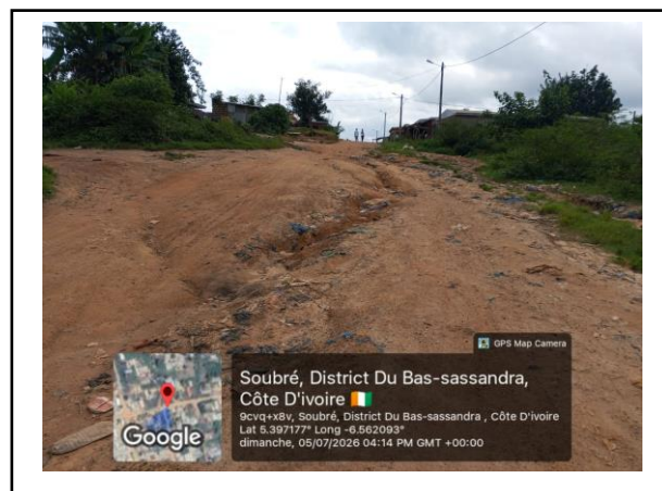
Photo 3 : Route en mauvais état au quartier Bayard
